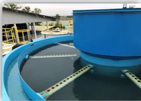
โครงการนิคมอุตสาหกรรมอมตะนคร บริษัท ซูเปอร์ วอเตอร์ พีพีเอส จำกัด : จำหน่ายน้ำประปานิคมอุตสาหกรรมอมตะนคร (ชลบุรี)
